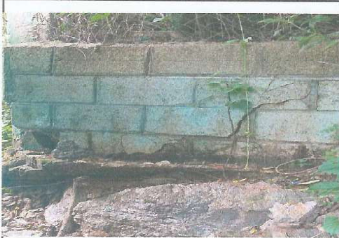
Foto1: muro perimetral colapsando
