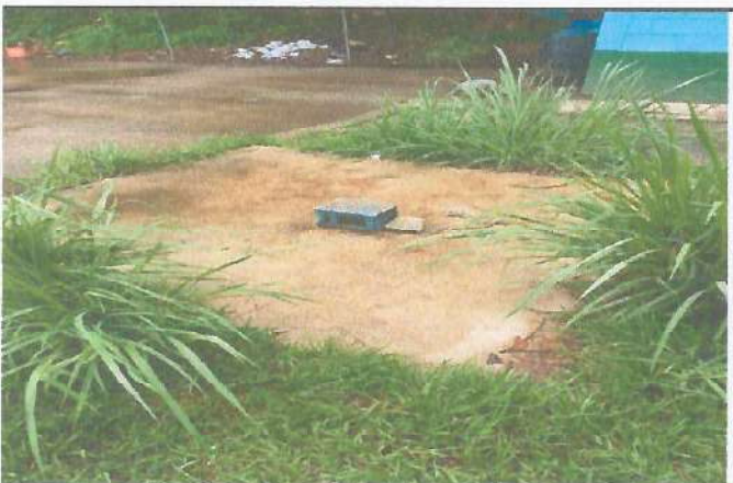
Foto 3: fosa septica en mal estado
