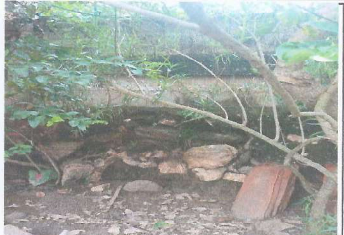
Foto 2: relleno del perimetro deteriorado
